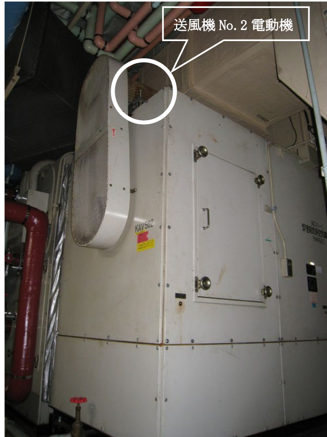
写真 2.8-14 炉室送風機全体写真(修理前)
