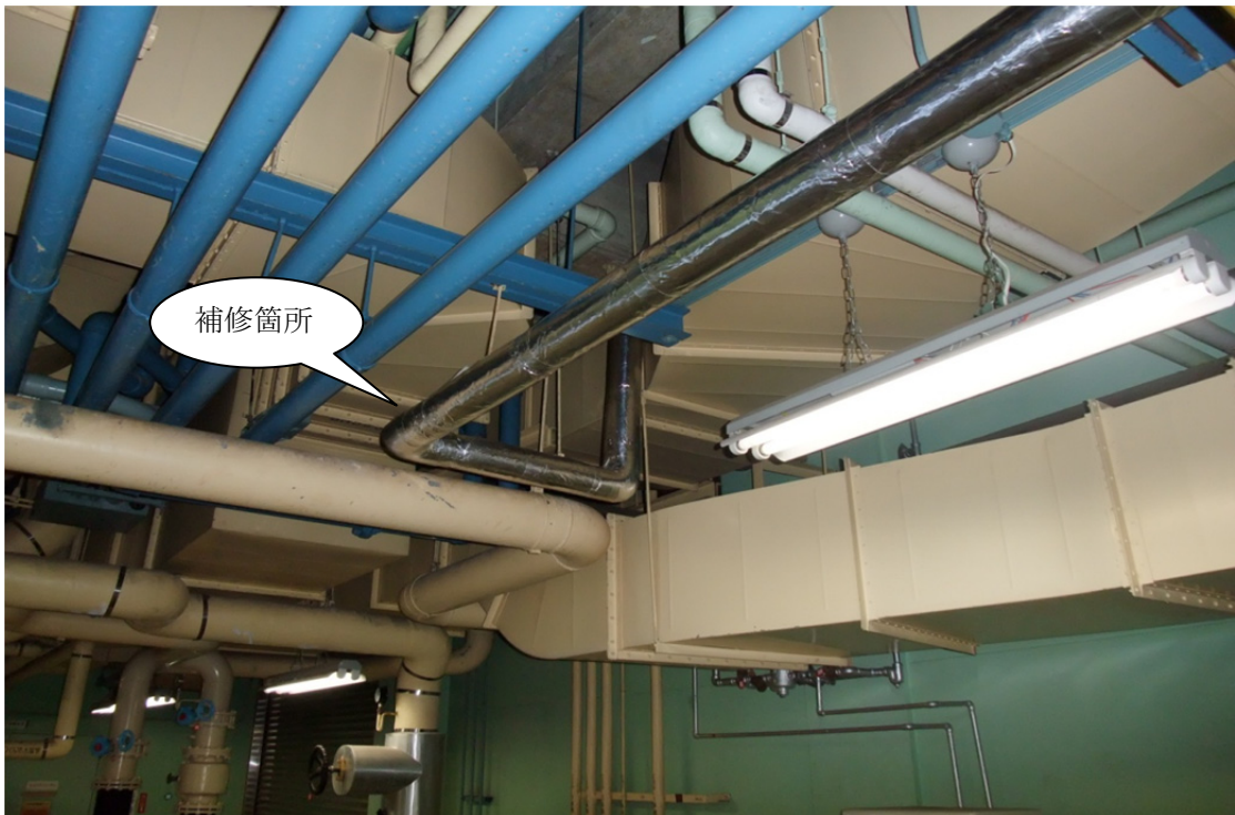
写真 2.8-20 機械室内熱交換器用補給水管漏水箇所の全体写真(修理後)
