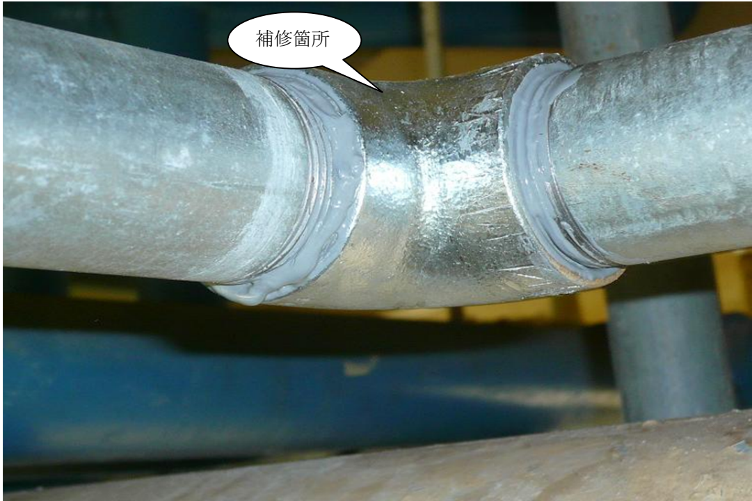
写真 2.8-19 機械室内熱交換器用補給水管漏水箇所の拡大写真(修理後)
