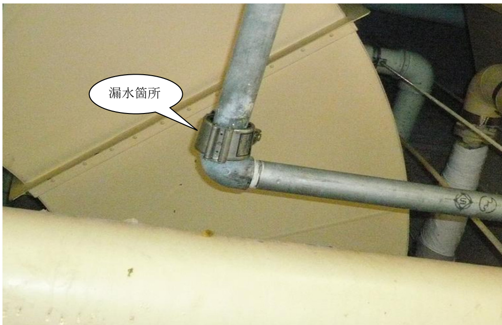
写真 2.8-18 機械室内熱交換器用補給水管漏水箇所の拡大写真(修理前)
