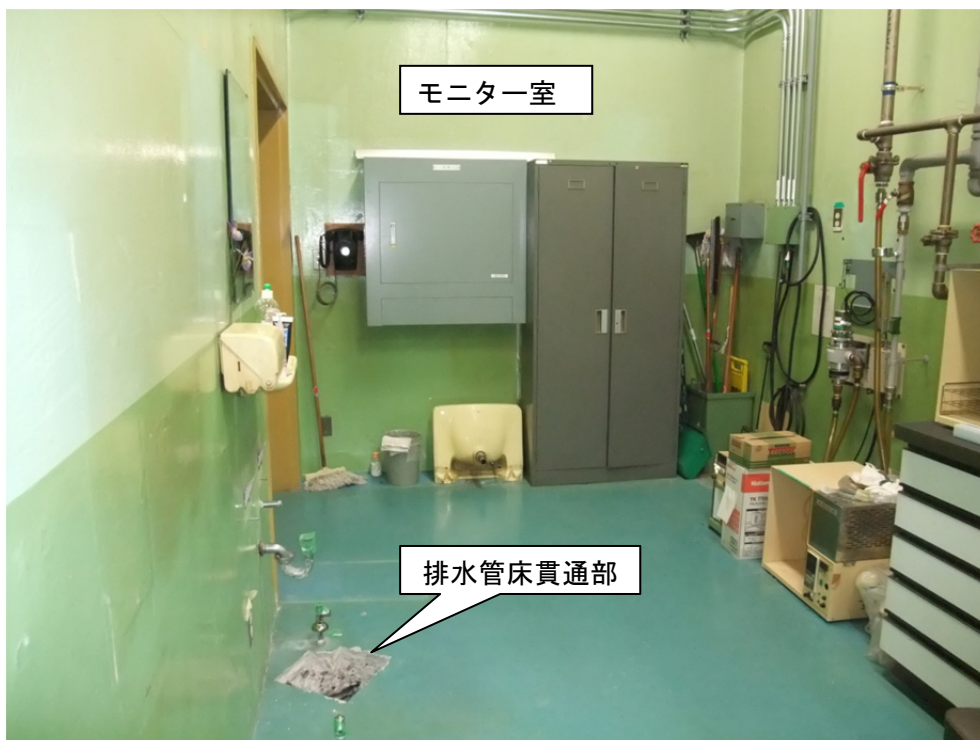
写真 2.8-4 排水管床貫通部全体写真(修理前)
