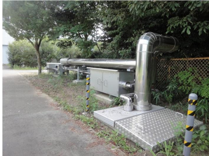
写真 2.11-11 蒸気バイパス管（旧リニアック棟南側）
