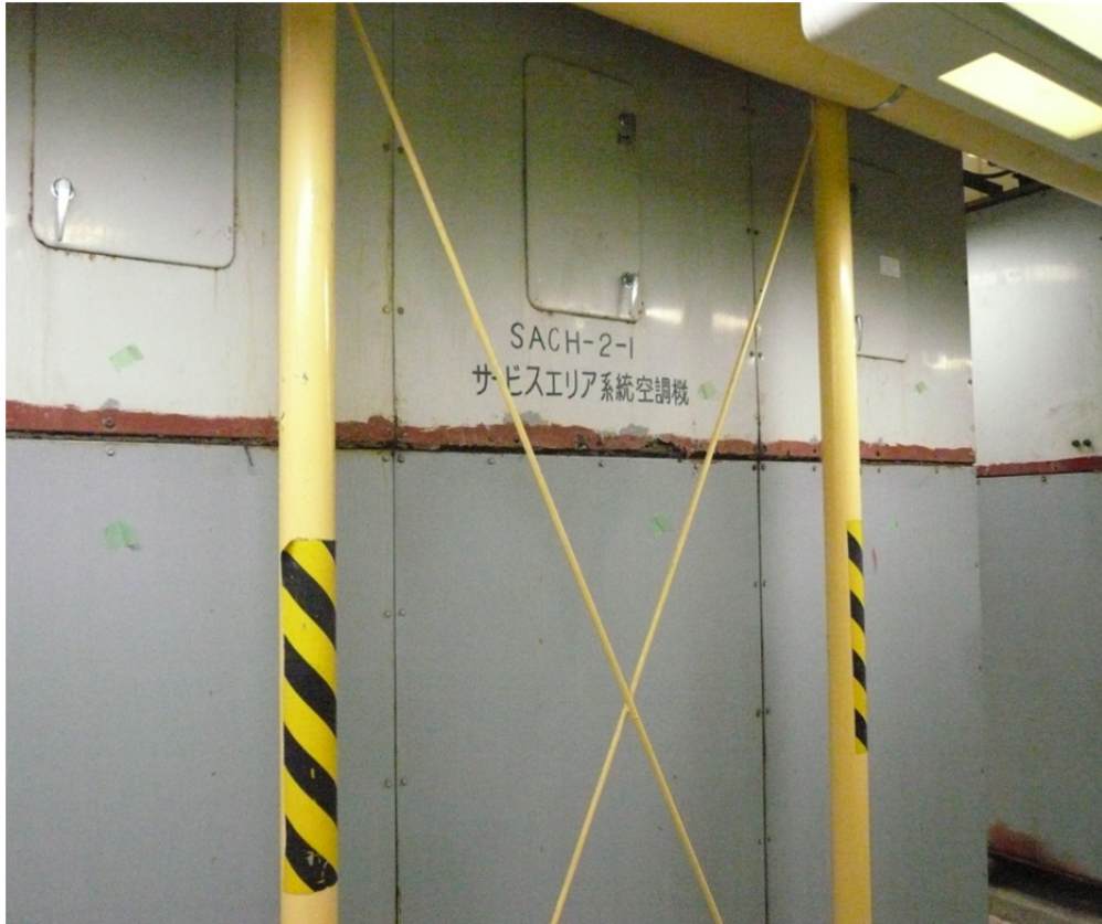
写真 2.8-21 空調機の全体写真(修理前)
