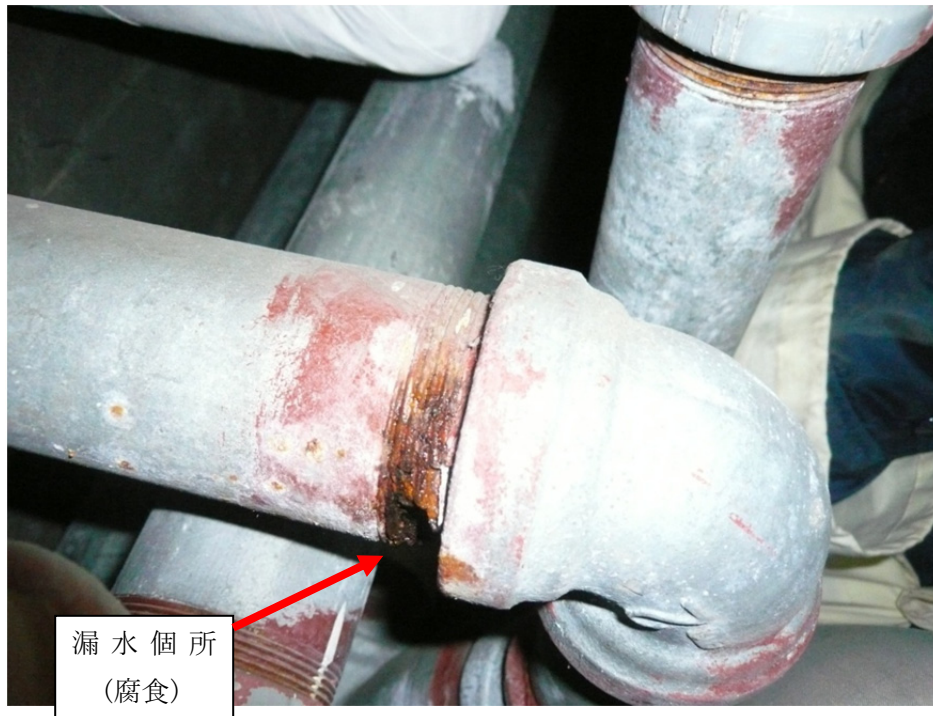
写真 2.8-25 一般排水管拡大写真(修理前)
