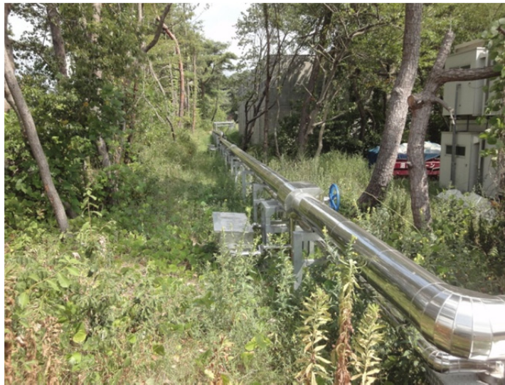
写真 2.11-9 蒸気バイパス管 (JRR-2 東側)
