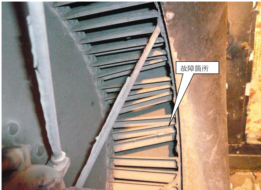
写真 2.8-22 ファン羽根の拡大写真(修理前)
