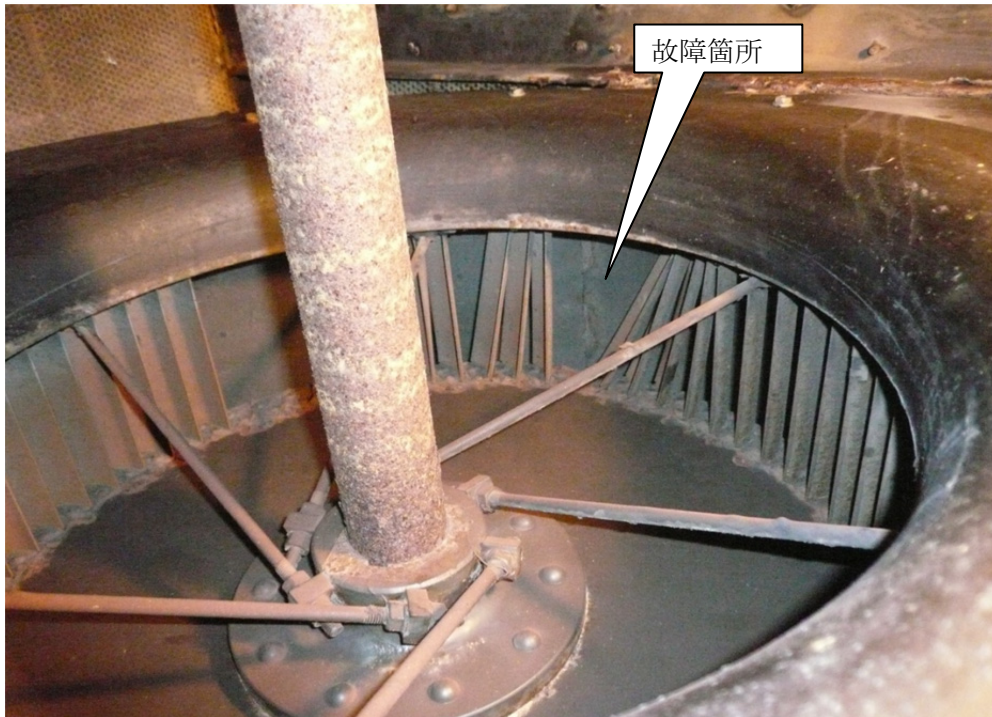
写真 2.8-2 ファン羽根の拡大写真(修理前)
