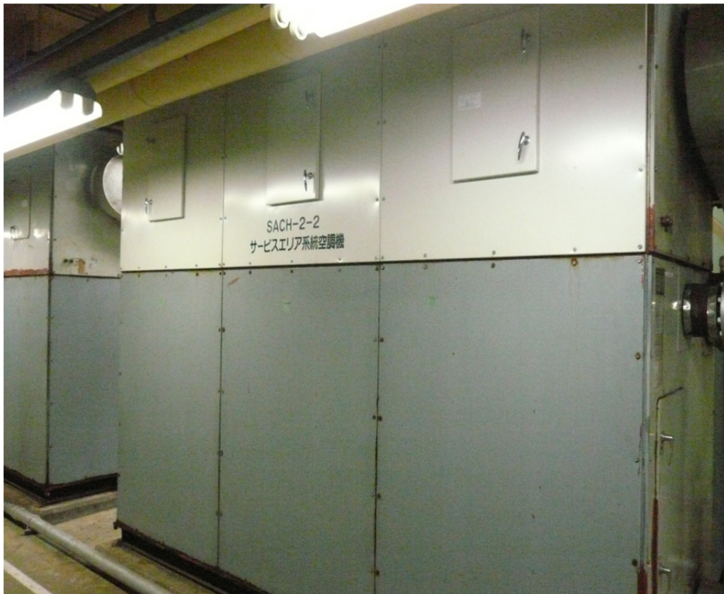
写真 2.8-1 空調機の全体写真(修理前)
