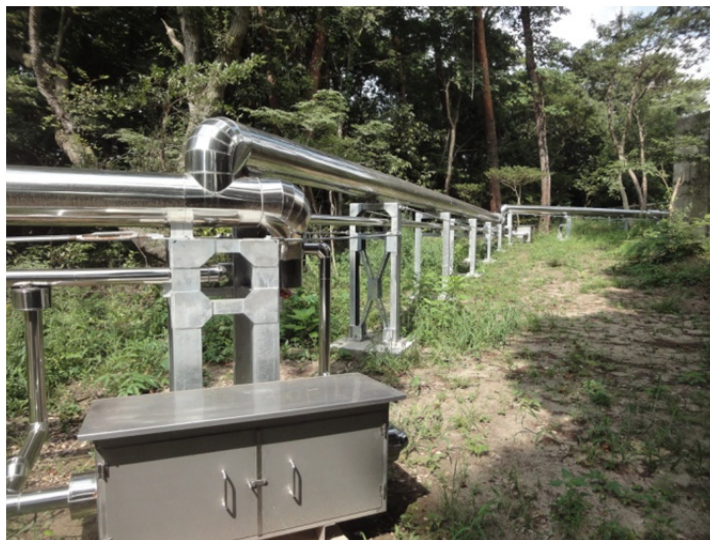
写真 2.11-10 蒸気バイパス管 (JRR-1 東側)
