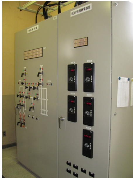
写真 2.11-4 中央変電所に設置した 66kV 系現場操作盤及び保護継電器盤
