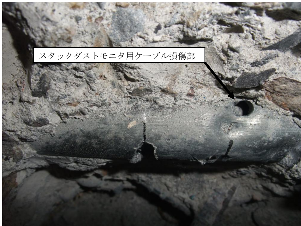
写真 2.8-5 スタックダストモニタ用ケーブル損傷部拡大写真(修理前)
