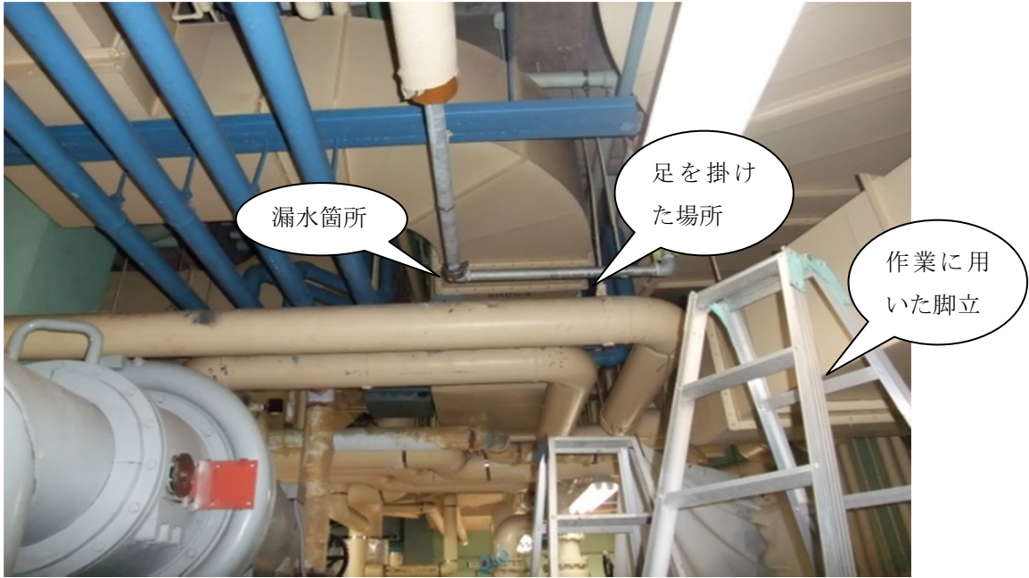
写真 2.8-17 機械室内熱交換器用補給水管漏水箇所の全体写真(修理前)
